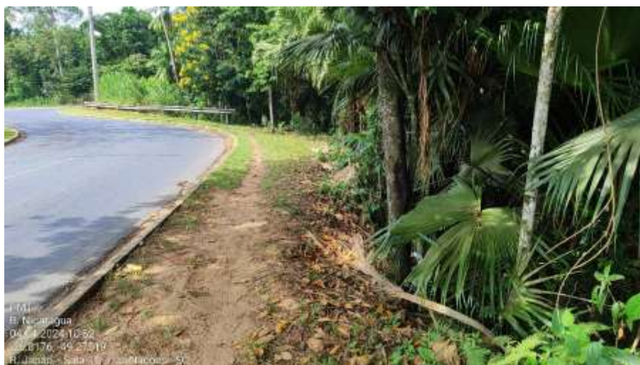
Figura 1 – Estado atual da calçada
