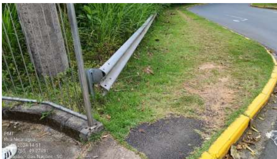
Figura 6 – Raio de curva atual, calçada sem pavimento
